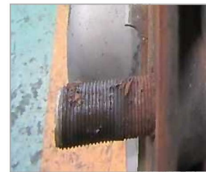
ボルトに著しいさびや汚れの付着
