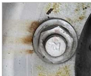
さび汁が流出した痕跡
